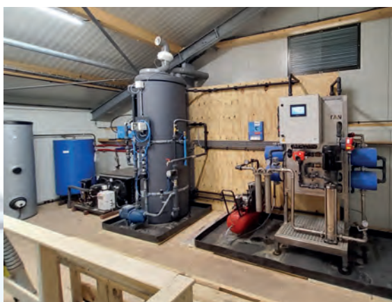
Een R710 multifilter van Remon achter een gesloten waterbehandelingssysteem, in dit geval een TITAN® Compact membraanfiltratie.
